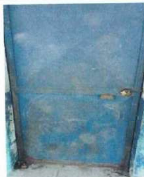
Foto 2: Deterioro de la estructura de la Puerta metálica
