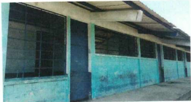
Foto 1: Deterioro de la estructura de pintura y ventanas metálicas.
