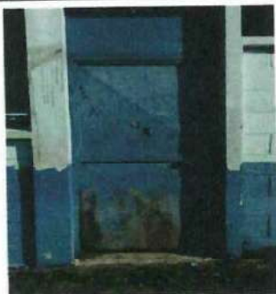
Foto 5: Deterio de la puerta del edificio escolar número 3
