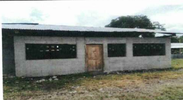
Foto 4: Falta de ventanas y puertas de cocina
