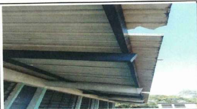
Foto 3: Deterioro de Láminas troqueladas del edificio escolar
