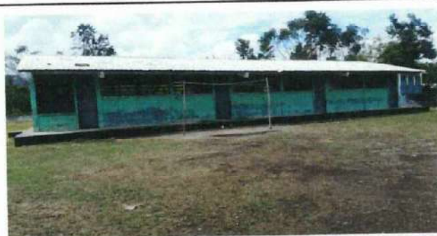
Foto 6: Deterioro de pintura del edificio escolar
